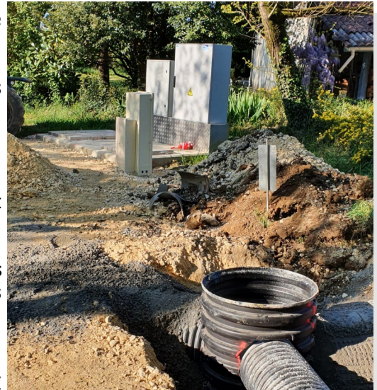
Pluvial + Poste de relevage Chemin de Fraigne
