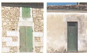
Ces moellons doivent être recouverts d'enduit.
