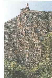
Conduit de cheminée tordu
